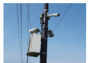
設置した防犯カメラ ▶
